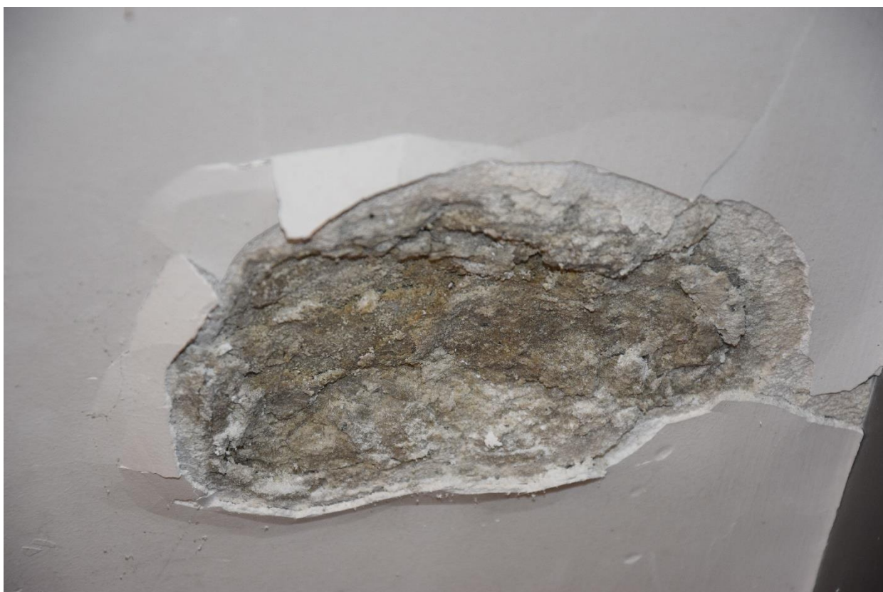
Fot. Odspojony tynk wewnątrz budynku. Stan zachowania na 2024 r.
