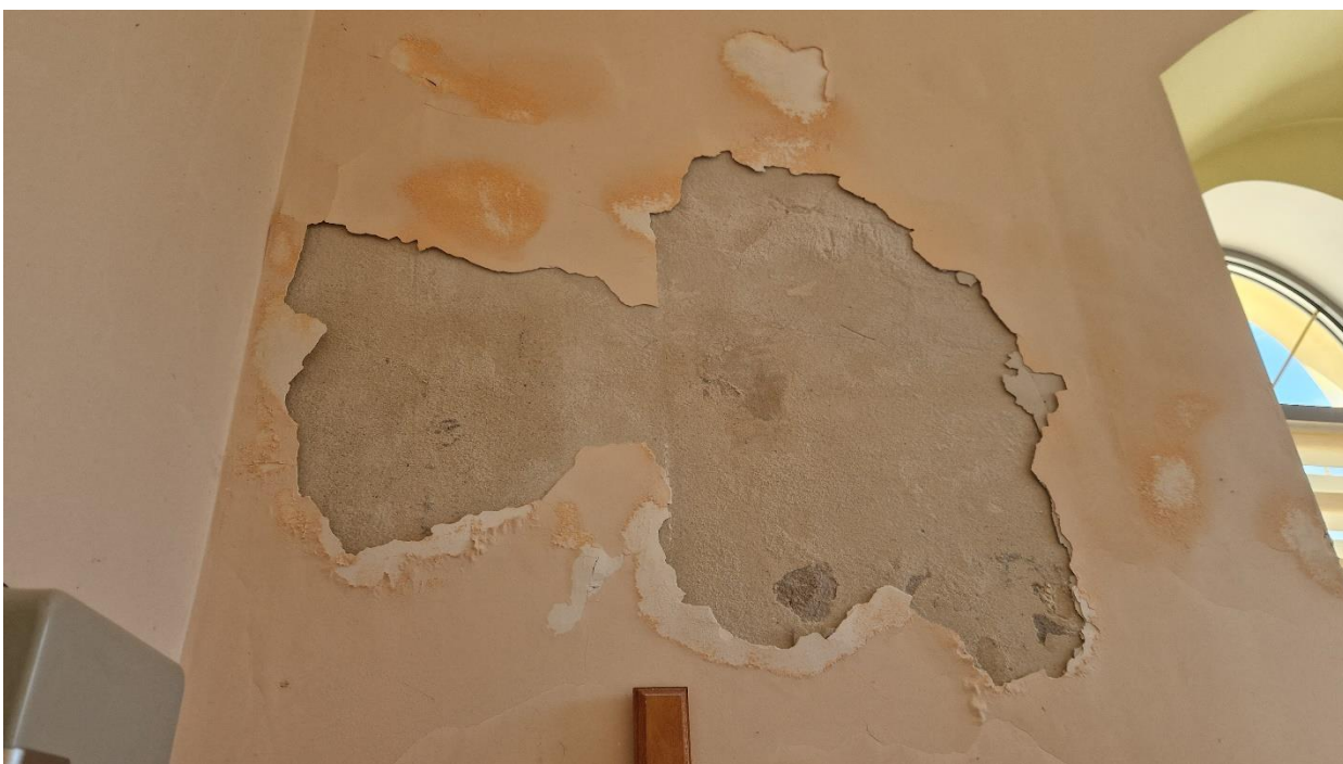
Fot. Odspojony tynk wewnątrz budynku. Stan zachowania na 2024 r.
