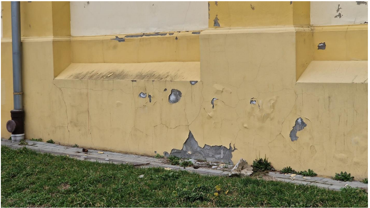
Fot. Zniszczona elewacja synagogi. Stan zachowania na 2024 rok.
