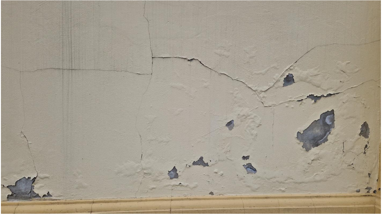
Fot. Zniszczona elewacja synagogi. Stan zachowania na 2024 rok.
