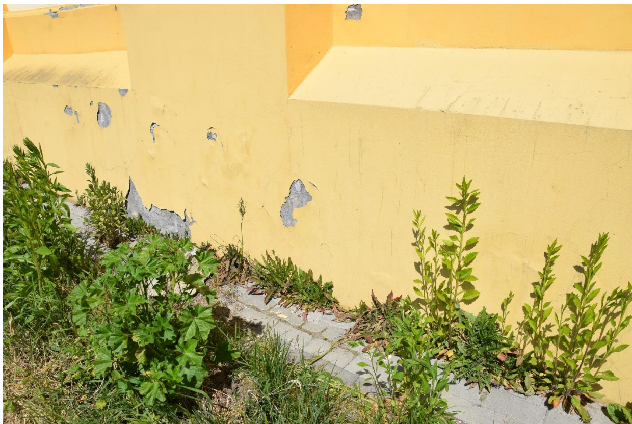
Fot. Zniszczona elewacja synagogi. Stan zachowania na 2024 rok.
