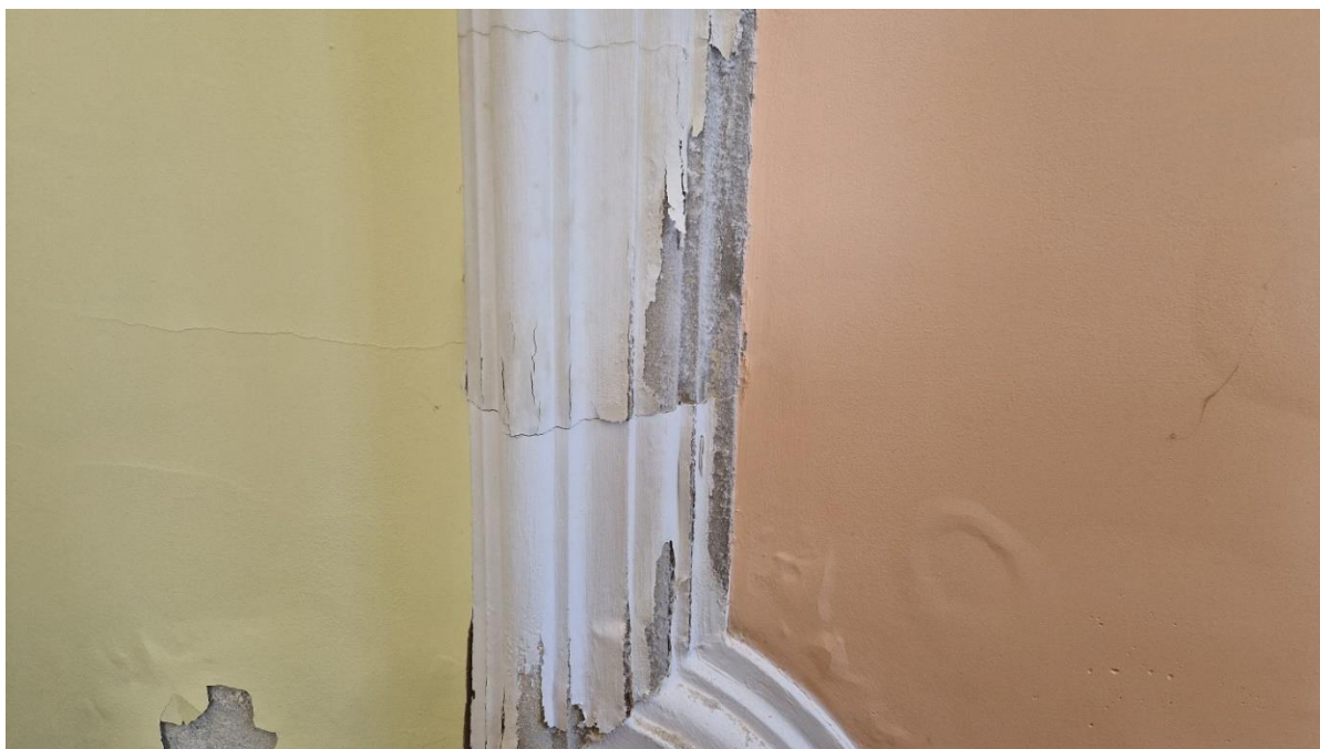
Fot. Zniszczona sztukateria wewnętrzna. Stan zachowania na 2024 r.
