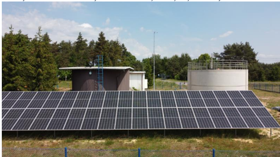
Ilustracja 9. Przebudowana stacja uzdatniania wody w Kobylnicy Wołoskiej
