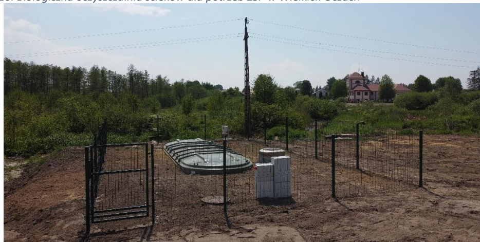
Ilustracja 10. Biologiczna oczyszczalnia ścieków dla potrzeb ZSP w Wielkich Oczach
