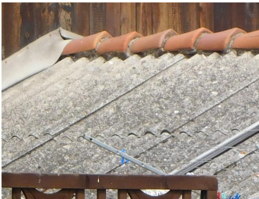
Fot. 1 Płyta azbestowa falista stosowana w budownictwie. Zdjęcie własne.
